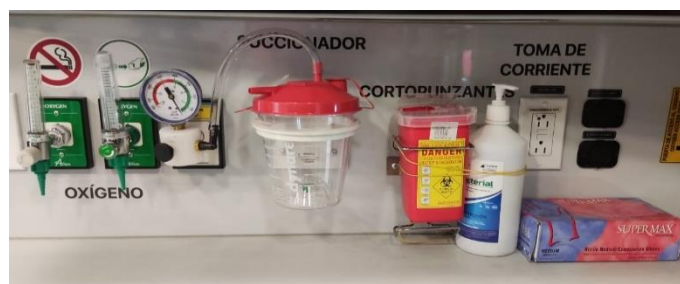
Base de equipos derecho
