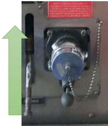
Gráfico 33. Apertura de válvula de paso de toma de hidrante (PONY)
