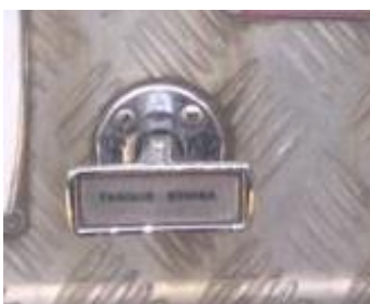
Gráfico 16. Válvula de tanque a bomba
