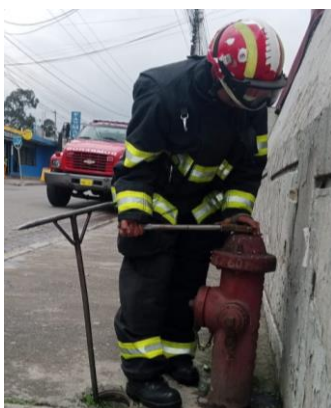
Gráfico 33. Apertura de válvula de paso de hidrante
